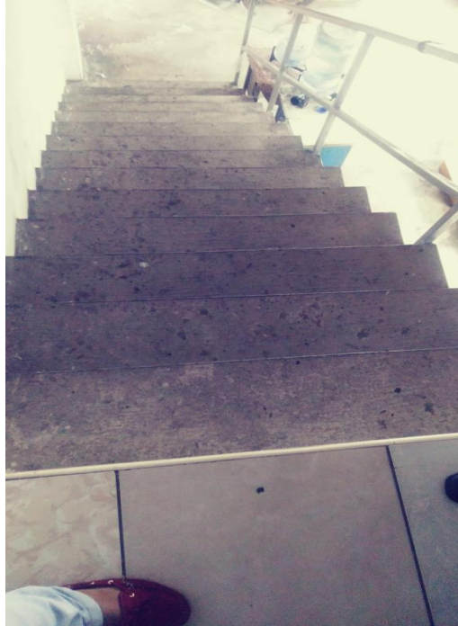
Ilustración 61 Previo señalización de gradas
