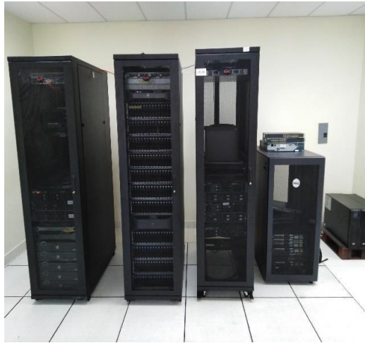
Figura 1 Vista del equipo de red del laboratorio de Data Center (fuente propia)
