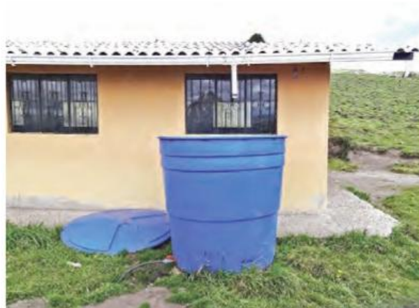
Tanque casero de 1.0 metro cúbico
