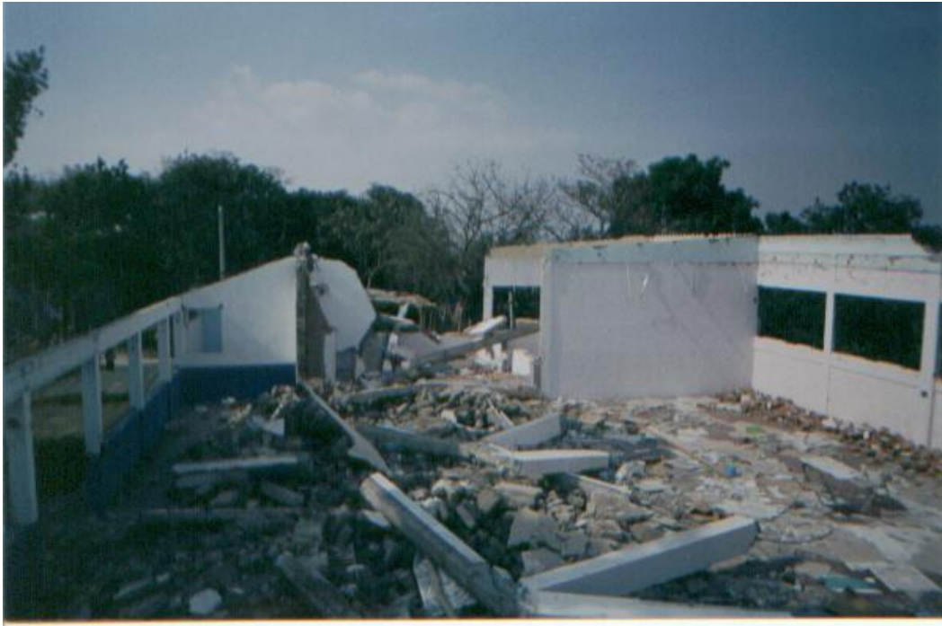
RUINAS INTERIOR ALCALDIA MUNICIPAL
