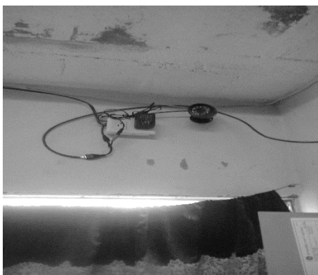
Fotografía # 7: Cámara # 3 (Salón de informática)
