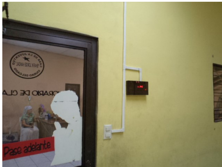
Sistema domótico instalado completamente.
