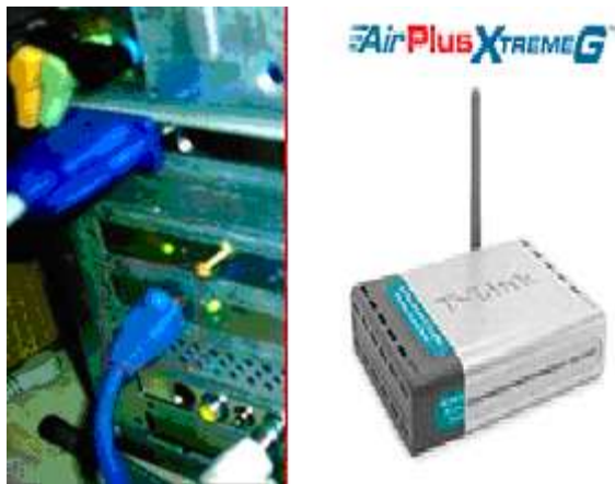
Imagen 4: Instalación del AP o Router Wireless (AP en este caso).
