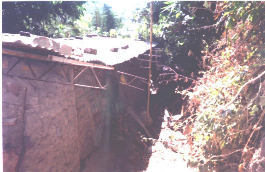
FOTO 2. Vivienda junto a talud sin protección
