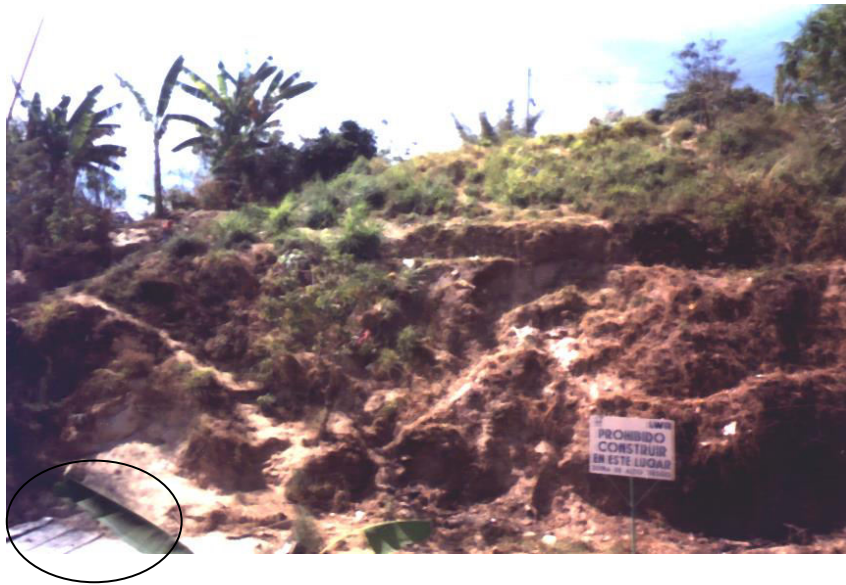
FOTO 1. Zona verde con riesgo de erosión y deslizamiento
