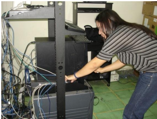
Figura 3.71 instalación de server
