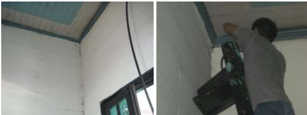
Figura 3.9 Área principal donde se distribuyó el poliducto hacia las demás aulas o salones.
