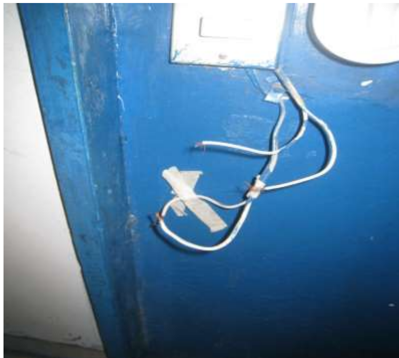
Imagen 2.2.2.2 Estado de las instalaciones actuales de los conmutadores
