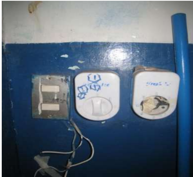
Imagen 2.2.2.1 Estado de las instalaciones actuales de los conmutadores
