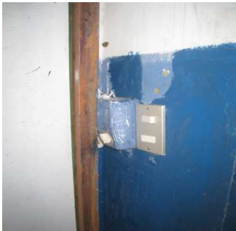
Imagen 2.2.2.4 Estado de las instalaciones actuales de los conmutadores
