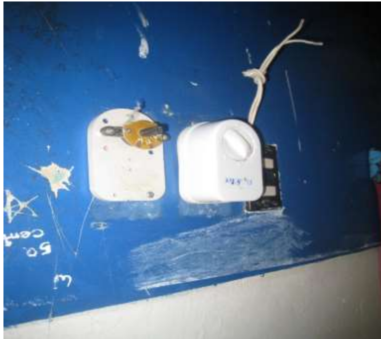
Imagen 2.2.2.3 Estado de las instalaciones actuales de los conmutadores
