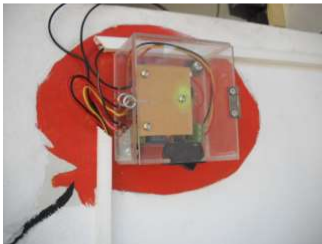
Sistema de control
