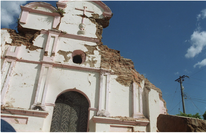
Daños sufridos en la iglesia de Ereguayquin, Usulután.
