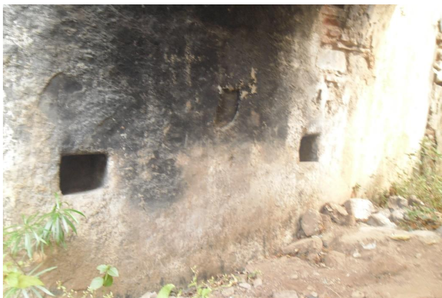
Figura 23. Marcas en los muros de los nichos.
