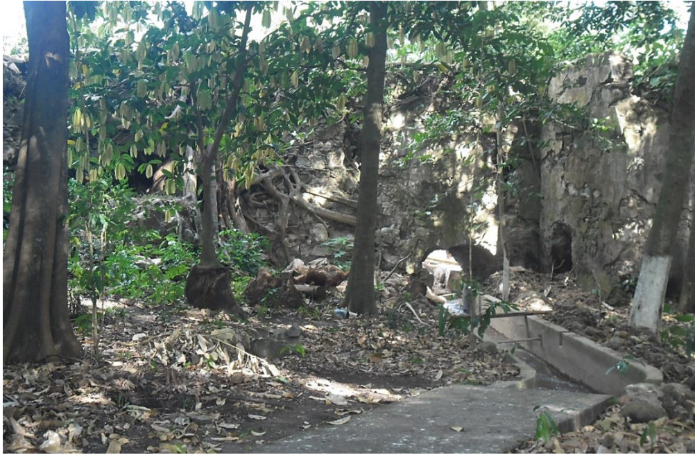
Figura 15. Vista de la canaleta moderna y un árbol adherido a la estructura. (Figura captada por Isis Pasasin, 2016).
