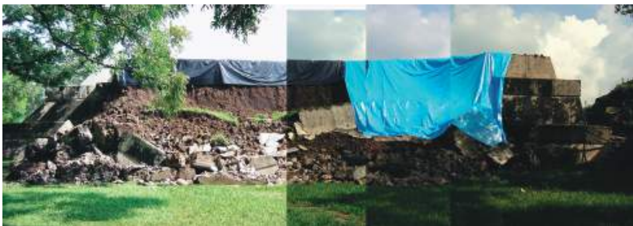
Fig. II-4 Después del derrumbe en el sector sur de la Estructura B1-2
