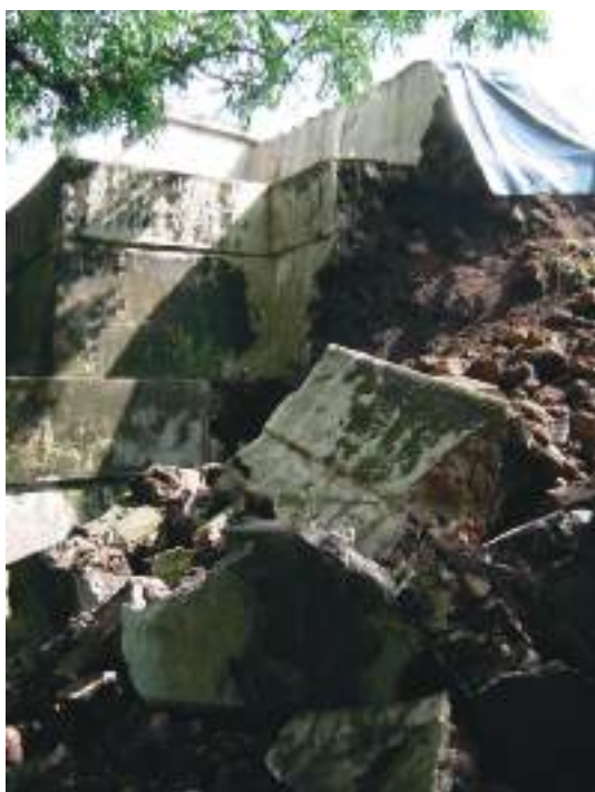
Fig. II-14 Colapso de la estructura restaurada con cemento por Boggs Hacia el noreste (Fotografía: Shinya Kato, 19, octubre, 2004)
