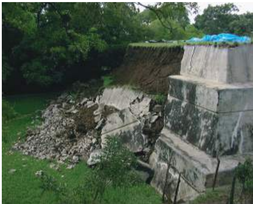
Fig. II-2 Después del derrumbe en el sector sur de la Estructura B1-2 Hacia el oeste (Fotografía: Shione Shibata)
