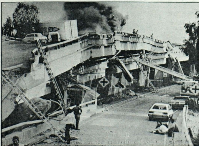
DERRUMBASE FREEWAY POR SISMO
