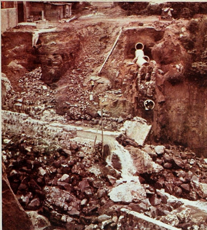
MOP ABANDONA TRABAJOS. El hundimiento que se produjo hace 6 meses en la antigua carretera a Soyapango, a pocos metros de la Cárcel de Mujeres, estaba siendo reparado por Obras Públicas, pero luego abandonaron los trabajos. La vía es de gran utilidad para el transporte.
