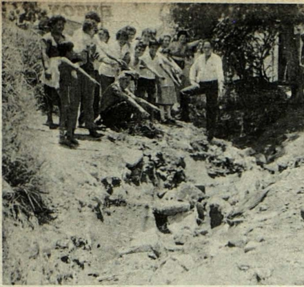
CALLE AGRIETADA. La colonia y Avenida San José, de Soyapango, ha que dado Incomunicada a causa de la grietas que han hecho las últimas lluvias en la calle. Los vecinos piden a Obras Públicas reparar la única vía de acceso que tiene la mencionada colonia.
