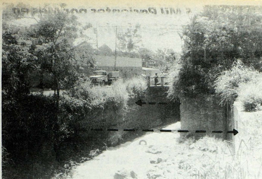
PELIGRO DE INUNDACION. La estrechez de la bóveda bajo la que pasa el río del arenal Monserrat, en la Calle Francisco Menéndez, frente al Cuerpo de Bomberos, no será capaz de evacuar la gran cantidad de agua que bajará, procedente de las nuevas colonias construidas entre Santa Tecla y San Salvador. Las flechas marcan la estrechez de la bóveda en relación al cauce del río.
