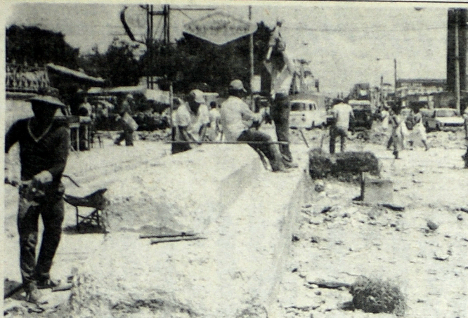
COSTOSO MURO. Este costoso muro, dejado por la alcaldía democristiana en la Av. Cuscatlán, es el que más dificultades causa a los obreros de la Municipalidad que trabajan en la reapertura de las calles.
