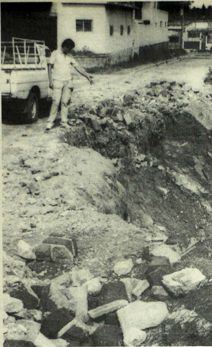
CALLE DESTRUIDA. La Avenida Yucatán, que sirve de acceso al Reparto Santa Lucía, en Mejicanos, ha quedado totalmente destruida al hundirse la vía. Los residentes de la mencionada colonia piden una urgente reparación al DUA, para habilitar el paso de los vehículos.
