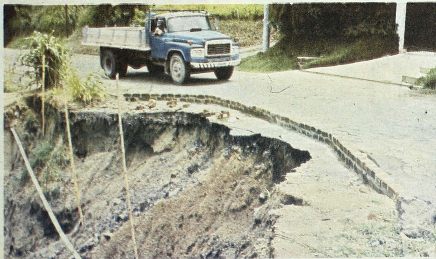
LOS PLANES PUEDE QUEDAR AISLADO. Los vecinos de los Planes de Renderos hacen un llamado a Obras Públicas, para que agilice la reparación de este tramo, el cual amenaza con dejar aisladas varias poblaciones y colonias. El derrumbe fue a causa del terremoto. También la carretera se encuentra en pésimas condiciones.
