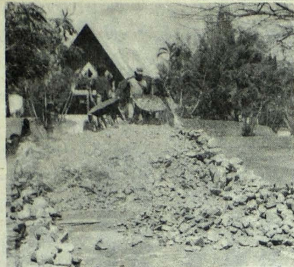
S.O.S. A OBRAS PUBLICAS. El promotorio de ripio que está en el Bulevar del Hipódromo, colonia San Benito, ya ocasionó el primer accidente de tránsito; milagrosamente no hubo desgracias personales. Los vecinos piden a Obras Públicas retire ese ripio.
