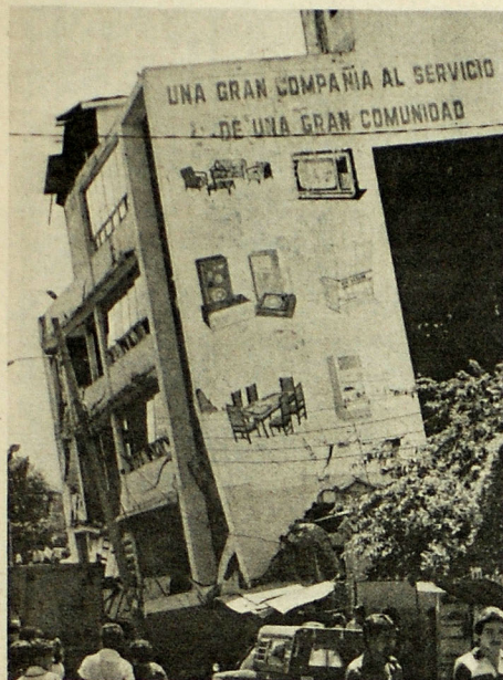
POR CAERSE. El edificio que albergaba las oficinas de la Compañía Tropicás, ubicado sobre la 8a. Av. Norte y 2a. Calle Oriente, quedó a punto de caerse como consecuencia del derrumbamiento de su primera planta, según se nos informó no hubieron desgracias personales que lamentar en este edificio.
