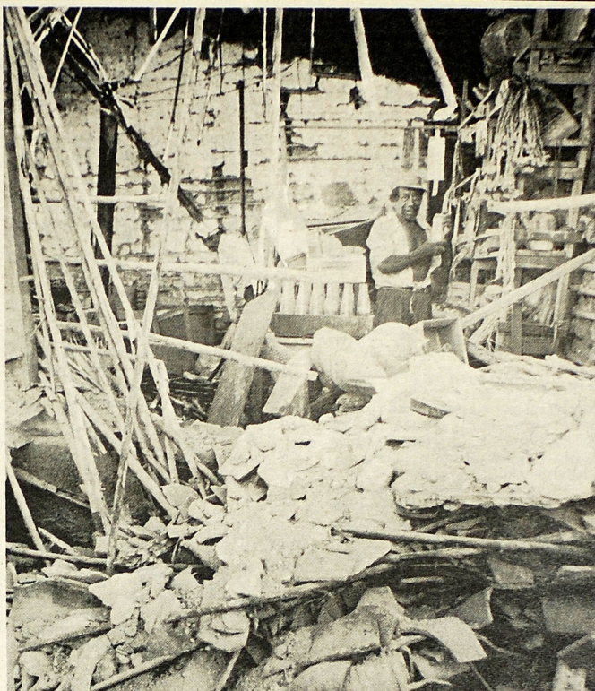
SAN JACINTO. Este sector fue uno de los más afectados por los fuertes temblores que han azotado San Salvador en las últimas horas. San Jacinto, contaba en su mayoría con viviendas de bahareque, las cuales no resistieron al movimiento telúrico que cobró centenares de muertos en diferentes puntos.
