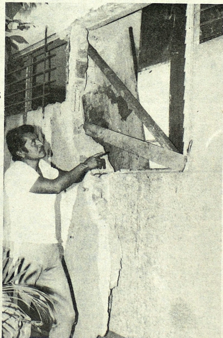
EDIFICIOS DAÑADOS. Un vecino señala los enormes hoyos y grietas que el terremoto causó en los multifamiliares de Mejicanos, en donde 80 familias han quedado sin hogar. Piden urgente ayuda.
