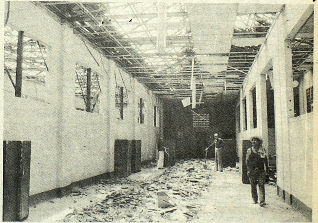
EL HOGAR DEL NIÑO. Los dormitorios de 580 huérfanos del Hogar del Niño quedaron destruidos por el terremoto. La capilla, el tanque de captación de agua potable, Administración y otras áreas, han quedado agrietados. La reconstrucción del edificio tendrá un costo de más de 3 millones de colones.
