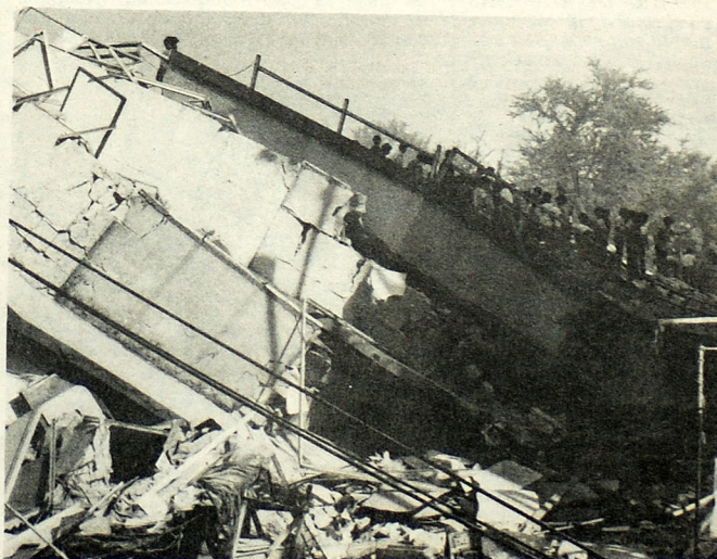
DAÑOS. La destrucción provocada por el sismo del 10, dañó mayormente...
