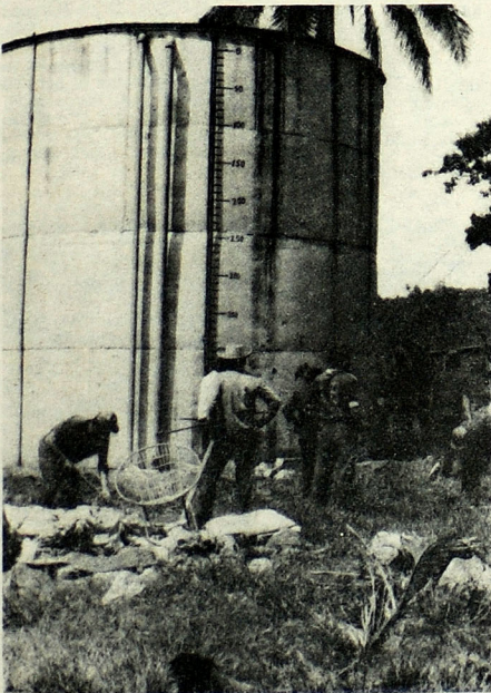
FUERA DE USO. — El tanque de captación, ubicado en el kilómetro 6 de la carretera a los Planes de Renderos, quedó fuera de uso al romperse a causa del fuerte temblor del viernes pasado.
