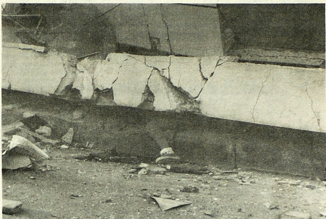
APLASTADO. La pesada estructura de un edificio se desplomó sobre este joven no identificado, que sólo alcanzó a poner una pierna fuera.
