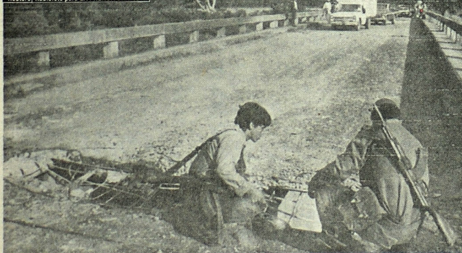
DAÑADO POR LOS CONTRAS. Sebaco, Nicaragua, Agosto 1 (Reuters). Dos soldados nicaragüenses constatan los daños causados al puente que cruza el Río Vie-
