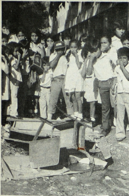
TUBERIAS ROTAS. En la Escuela República de Mejiicanos, tienen un mes de haberse roto las tuberías de aguas negras, sin que las autoridades de Educación y Obras Públicas solucionen el grave problema, que afecta a tres mil alumnos. La hedentina es insostenible y se teme una epidemia.
