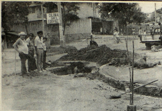
SIN AGUA LA SANTA LUCIA. — Hasta ayer al mediodía varios sectores de la colonia Santa Lucía, Ilopango, estaban sin agua debido a un derrame que se produjo frente a la colonia Santa Ediviges, donde se formó un hoyo de unos dos metros cuadrados.
