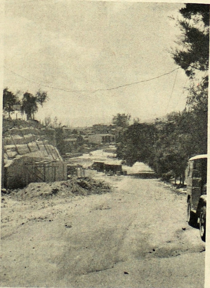
TRABAJOS ABANDONADOS. Los trabajos que realiza DUA al final de la avenida Bernal, en colonia Guerrero, están abandonados desde hace meses, con serias molestias para los vecinos.
