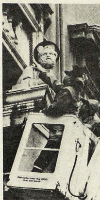
EN ACCION. Roma (ANSA). Los bomberos de esta ciudad inspeccionan la fachada del Quirinal, justamente sobre la puerta de la entrada. El quirinal perdió un detalle arquitectónico en la entrada principal del Palacio Presidencial.
