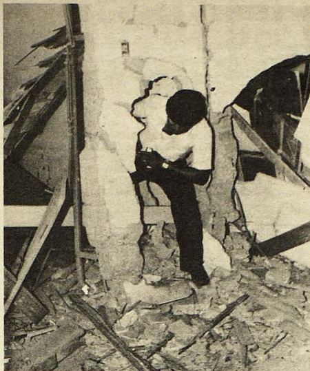
DAÑOS MATERIALES. Considerables daños materiales, ocasionó anoche la explosión de una bomba de alto poder explosivo, en las oficinas centrales del Banco Internacional de El Salvador, ubicadas en la Alameda Roosevelt. En la
