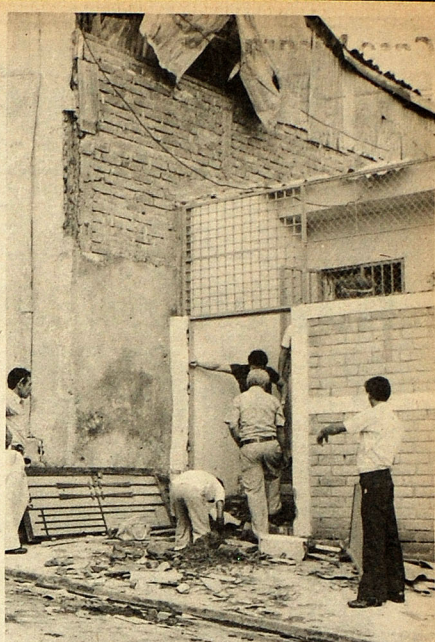
POR SEGUNDA VEZ COLOCAN BOMBA. — Sobre la 9ª Calle Pte., casa N° 10, de Mejicanos, terroristas colocaron una bomba por segunda vez, que al explotar causó pérdidas materiales por 20 mil colones. Las casas vecinas sufrieron daños de consideración, a causa de las ondas expansivas. La familia Melara ignora los motivos de los atentados.
