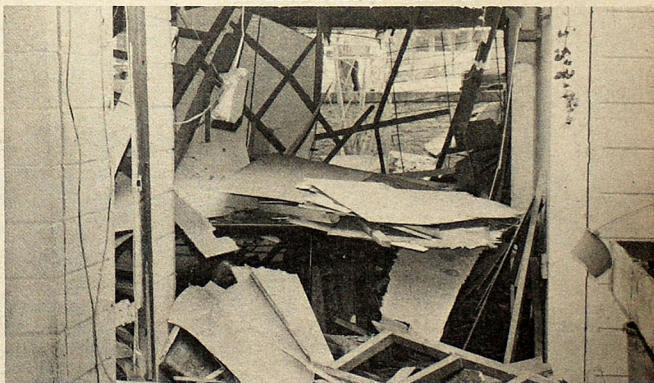
DANOS EN EDIFICIO CARBONELL.— Ayer a las 5:45 de la mañana, terroristas colocaron una bomba en el edificio Carbonell N° 1, que al explotar dejó grandes daños en dicho edificio. La Sra. Marta Torres se salvó milagrosamente de morir soterrada por los escombros.
