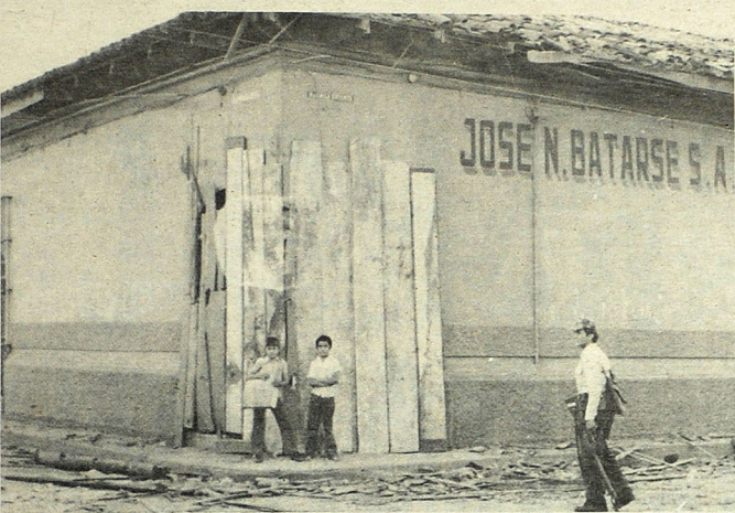
DAÑOS DE CONSIDERACION.— (San Miguel). Una bomba de alto poder explosivo que estalló el jueves a las seis y media de la tarde, en el almacén "José N. Batarse", de esta ciudad, causó daños en puertas, techo y parte del mobiliario. FOTO DE RAMÍREZ.
