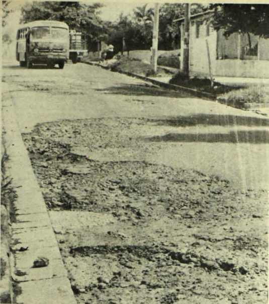
CALLES DESTRUIDAS. Todas las calles de la Colonia Santa Lucía, de Ilopango se encuentran destruidas. Los buseros amenazan con no pasar con sus vehículos si la municipalidad y DUA no las mandan a reparar. (Foto de Peñate Zambrano).
